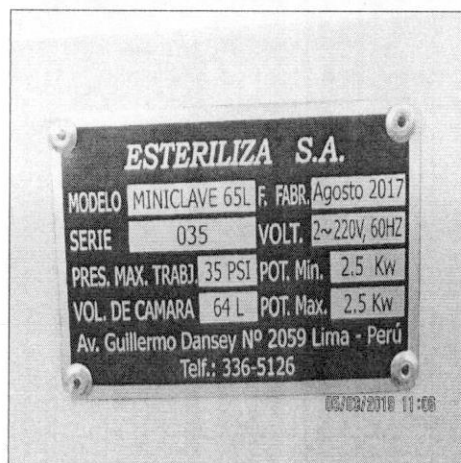
Esterilizador con generador eléctrico a vapor 50Lt, instalado en el área de Lavandería del Centro de Salud San Genaro de Villa.
